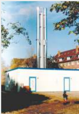
Wärme- und Kälteversorgung
